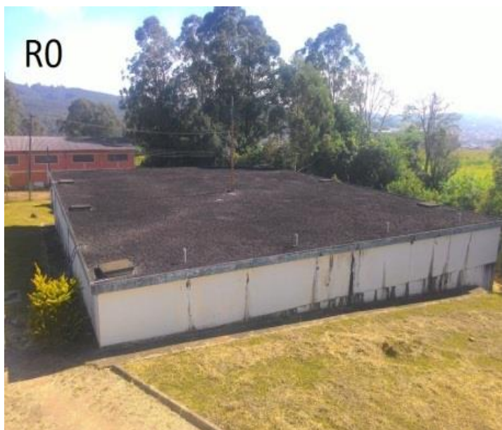
Figura 02 - Reservatório R0 - ETA Matarazzo
